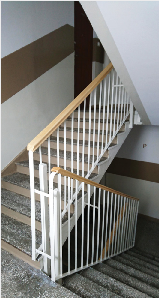
Odnowiona klatka schodowa na Kosynierów Kościuszkowskich 12. Do końca maja wyremontowano 22 klatki z 94 zaplanowanych w roku 2016
