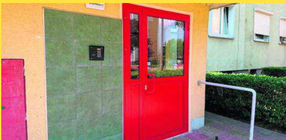
W bieżącym roku nowe drzwi wejściowe zamontowano w 12 budynkach – na zdj. Wyszyńskiego 13A
