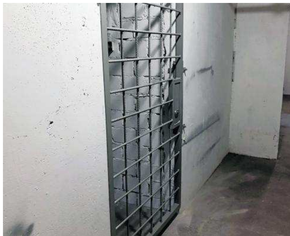
Pomyśl nad dodatkowym zabezpieczeniem piwnicy. Możesz założyć np. kratę antywłamaniową wraz z sąsiadami
