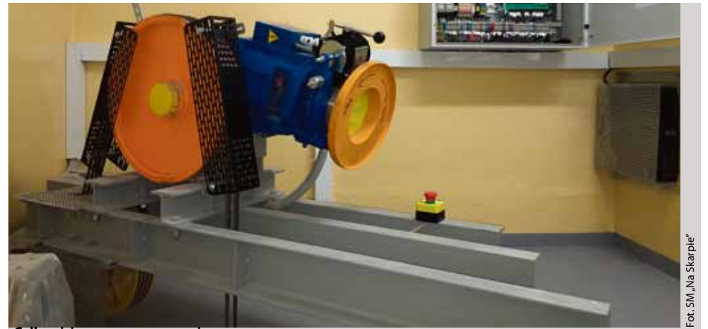
Całkowicie nowa maszynownia
