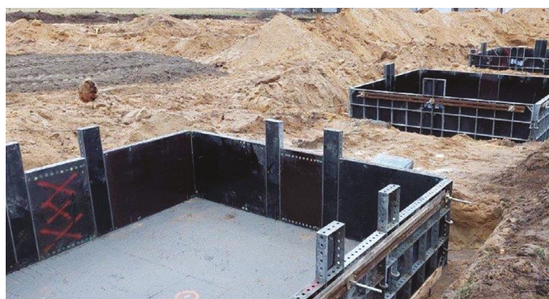
Na budowie parkingu Park&Ride przy ulicy Olimpijskiej wykonano pierwsze fundamenty, które będą stanowiły podpory przyszłych klatek schodowych.
