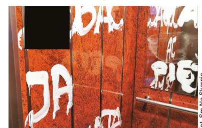
Zdewastowana kabina windy przy ul. Szosa Lubicka 160A
