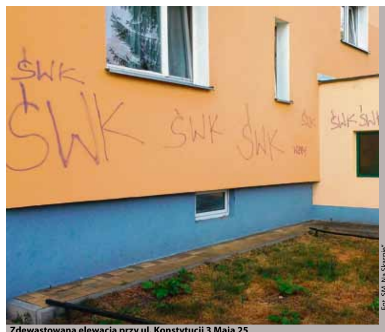
Zdewastowana elewacja przy ul. Konstytucji 3 Maja 25
