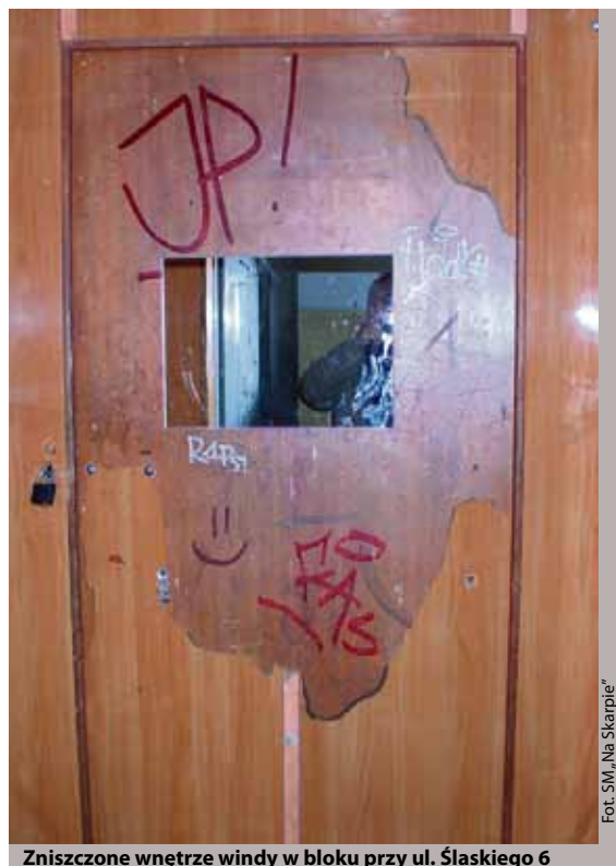
Zniszczone wnętrze windy w bloku przy ul. Śląskiego 6
