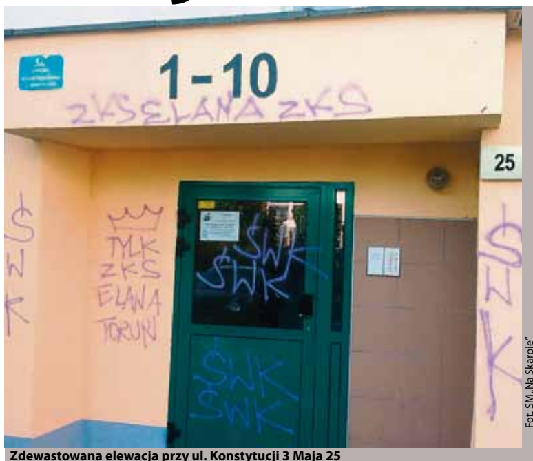
Zdewastowana elewacja przy ul. Konstytucji 3 Maja 25
