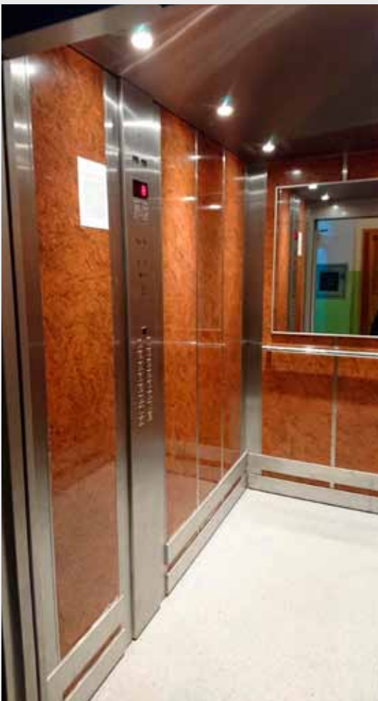
> NOWA SIÓDMA WINDA W ROKU BIEŻĄCYM (UL. KARD. ST. WYSZYŃSKIEGO 15 A) Z PLANOWANYCH 12-U DO KOŃCA ROKU
