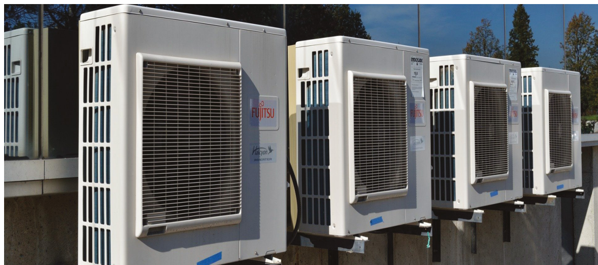
Klimatyzatory mogą już chłodzić nasze powietrze w mieszkaniu. Jak legalnie dokonać ich montażu?
