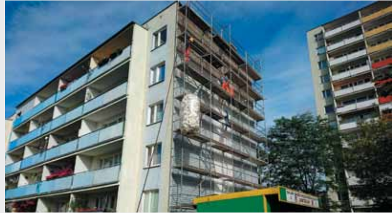
REMONT SZCZYTU BUDYNKU PRZY PREJSA 1 TO JEDNA Z TRZECH TEGO TYPU MODERNIZACJI ZAPLANOWANYCH NA TEN ROK
